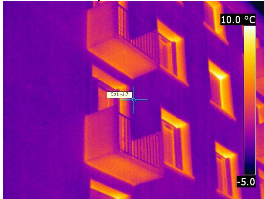
Ponts thermiques des balcons.
